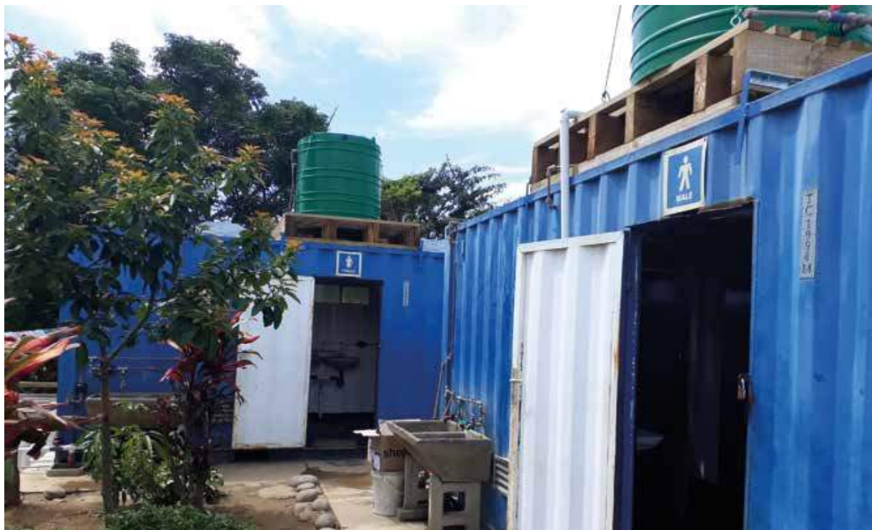
Figure 5.5 Bloc de toilettes commun doté d'installations pour le lavage des mains.
